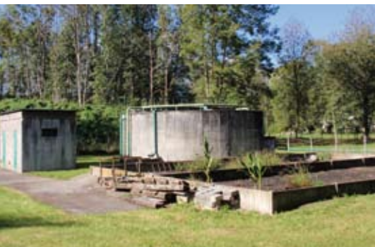
Arras-en-Lavedan et d'Arrens-Marsous entament la réhabilitation de leurs stations d'épuration et des réseaux d'assainissement.
